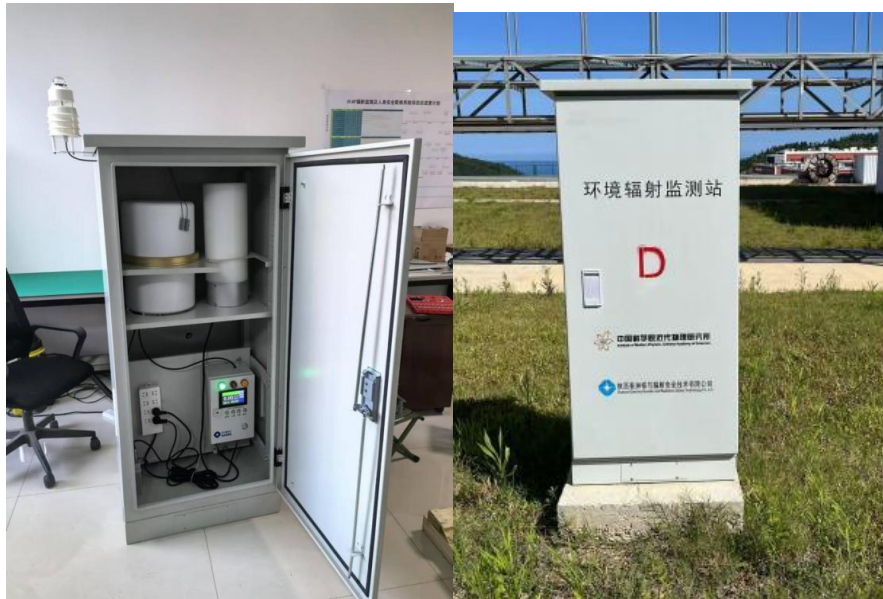
图 5-57 环境监测站实物照片
