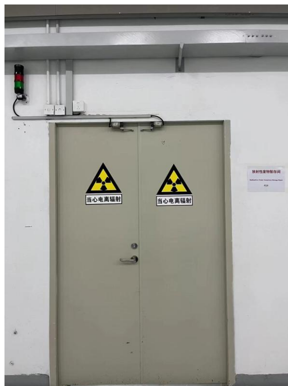
图 5-66 放射性废物暂存间现场照片
