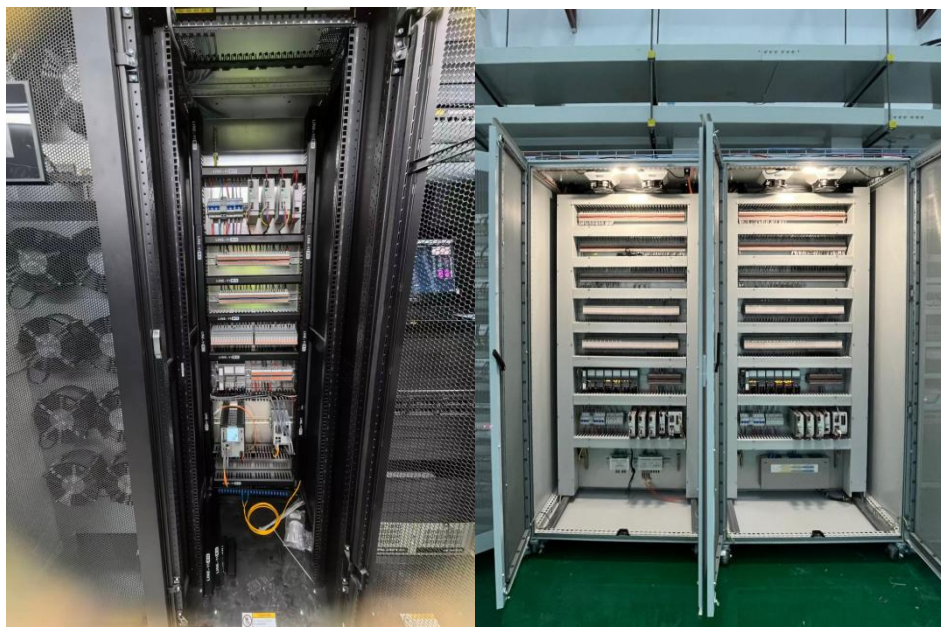
图 5-35 PLC 系统实物照片
