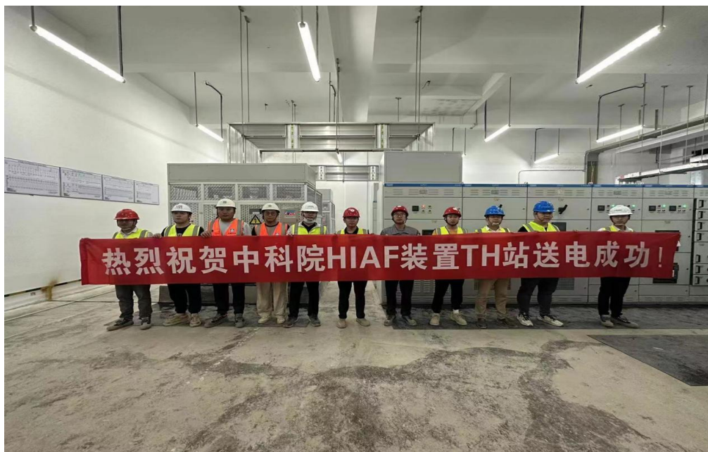
图 4.1 综合测试大厅 TH 配电站
