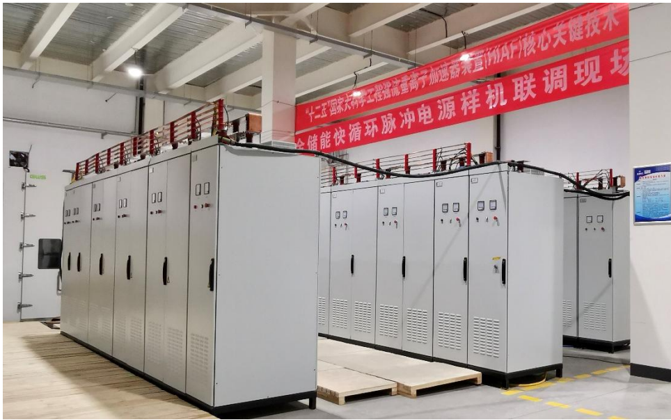
图 2.2 全储能快循环脉冲电源整机联调现场
